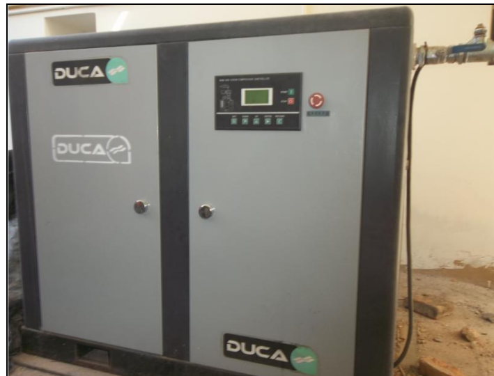
Figura 20: Compresor de aire que alimenta al gasificador.
