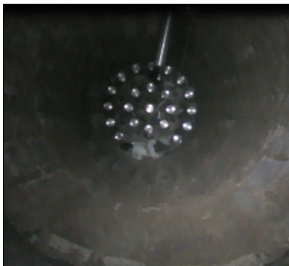
Figura 18: Vista interior del reactor sin carga de arena.
