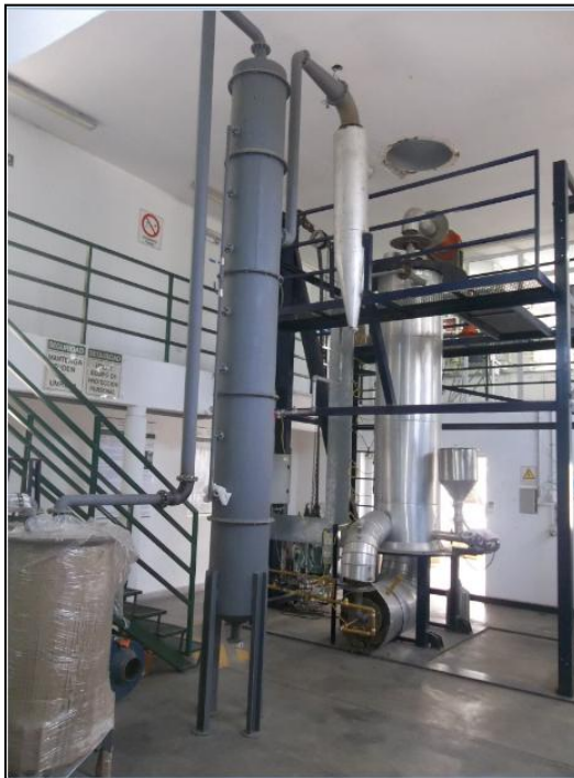
Figura 17: Equipo gasificador de biomasa de lecho fluidizado instalado en la EEAOC.
